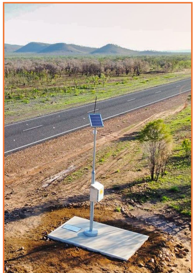
Poste, panel solar y gabinete suministrado por el cliente
